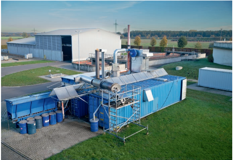
Die kompakte LANDGAS THERMODIREKT-Anlage braucht weniger Fläche als ein Tennisplatz und ist in kurzer Zeit einsatzbereit.
